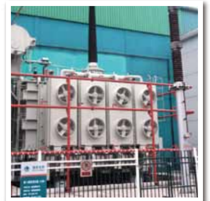
换流变压器在葛洲坝现场投运
